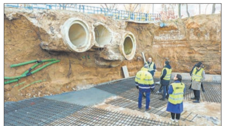
El alcalde de Toledo, Carlos Velázquez supervisa las obras del sistema de retención de sólidos en Azucaica.
