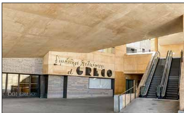
Tras años de espera, los ciudadanos verán esta infraestructura reparada gracias al pago de Acciona Construcción y la licitación del proyecto de impermeabilización.
